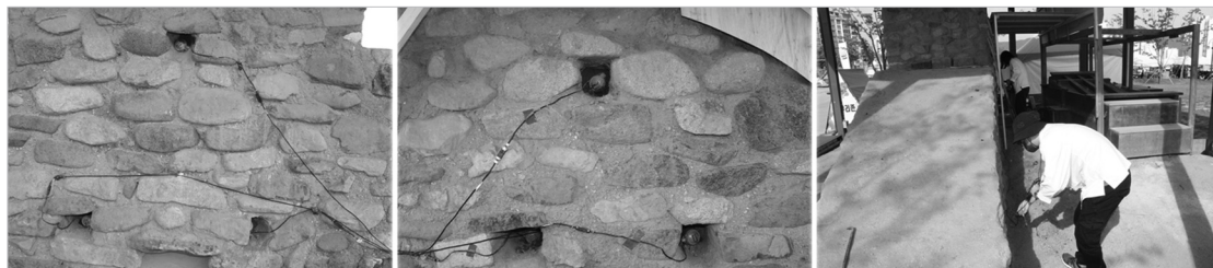
<그림 27> 온도센서 설치 모습(좌:앞창쪽, 중:골구멍쪽, 우:설치모습)
