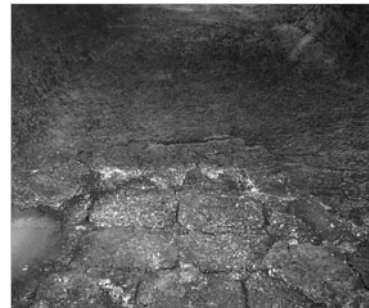
〈사진 109〉 우측 벽체 상부
