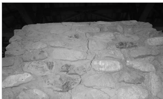
〈사진 100〉 북벽 균열(10:25)
